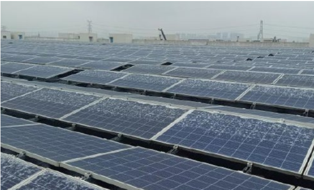
无锡基地光伏发电项目
