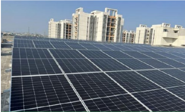
广州总部光伏发电项目
