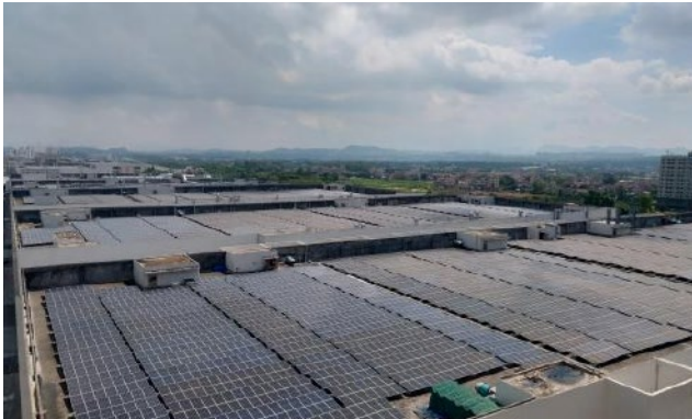
天津基地光伏发电项目(新建生活区)
